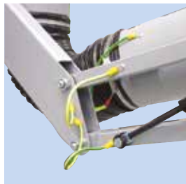
Coude Bas de la coude avec des connexions de câble de terre au parallélogramme.
